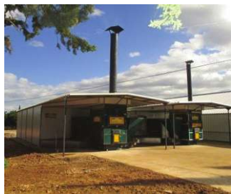
Sušare smeštene u objektu
